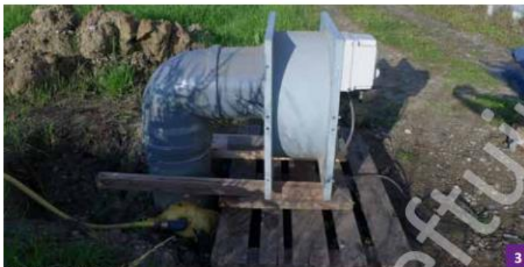
De ventilator op de pompput
