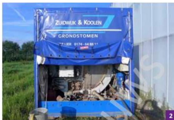
2 De slurven van de stoomketel naar de grondserre
