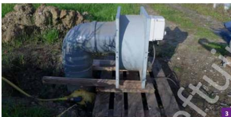
3 De ventilator op de pompput
